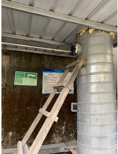
DA028 排气筒（输送、配料搅拌 废气）处理前
