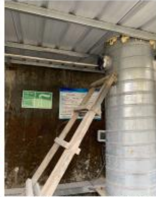
DA030 排气筒 (上料、球磨工序 废气) 处理后
