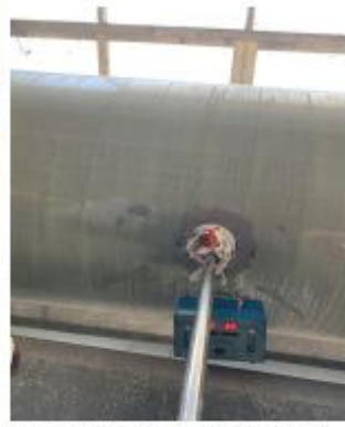
DA029 排气筒 (氨气吸收工序) 处理前
