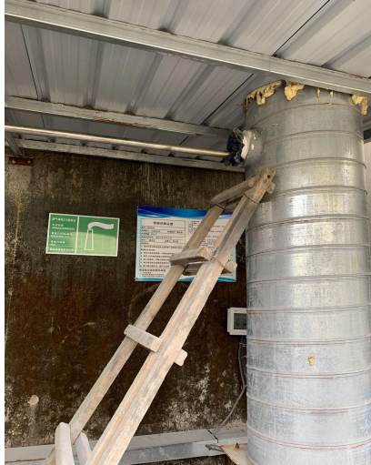
1#排气筒（上料、球磨工序废气） 处理后
