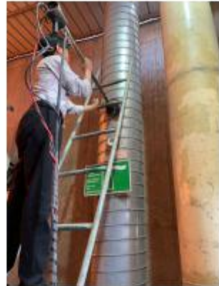
DA028 排气筒 (输送、配料搅拌 废气) 处理后
