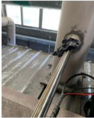
DA030 排气筒 (上料、球磨工序 废气) 处理前
